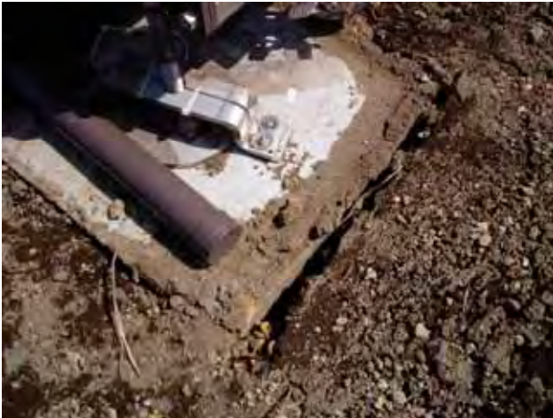
写真－4 M浅間鎌原（凍結の結果生じた基礎の隙間）
