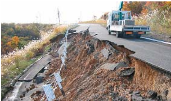
写真-5 崩落した道路（魚沼市）
