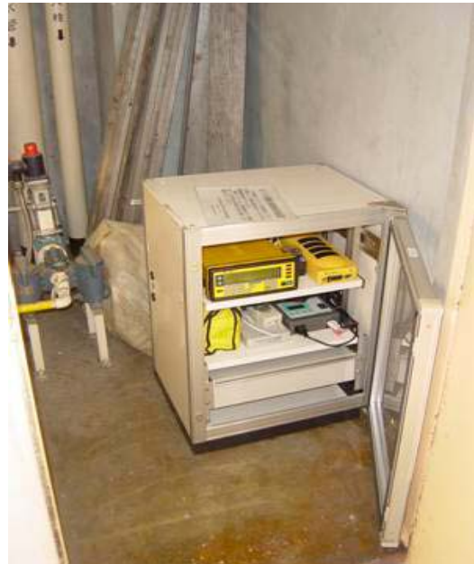
写真-4 収納ラック
