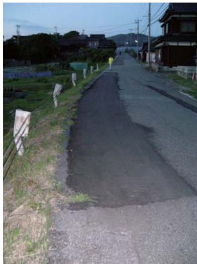
写真-3 海側（写真左）への地表の変形を示す道路上の亀裂の補修跡
