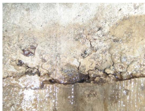
写真-4 「輪島」で確認された観測井戸の亀裂からの地下水の浸入（2010年11月）
