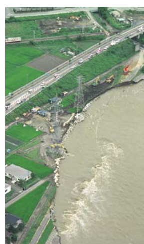
図-3 天竜川堤防決壊（箕輪町松島地区） （7月20日、日本空間情報技術撮影による）
