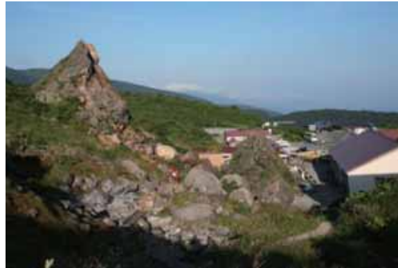
写真-23 須川温泉の大日岩 岩手・宮城内陸地震時 岩塔右側 が崩落した (2010年8月撮影)
