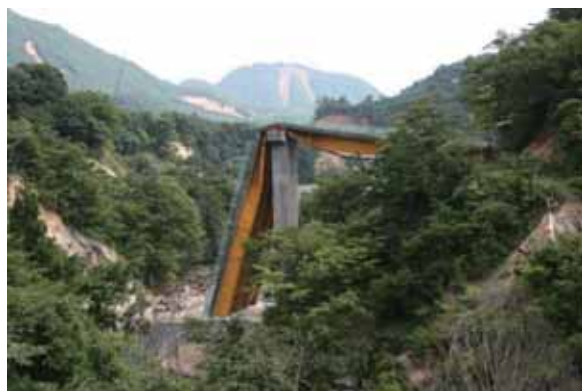
写真-33 一関市 まつるべ 祭時大橋の損壊状況 地震時に発生した地すべりにより 損壊 (2010 年 8 月撮影)
