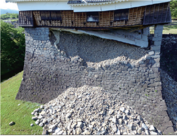
図-12 UAVで撮影した熊本城の被災状況（動画）
