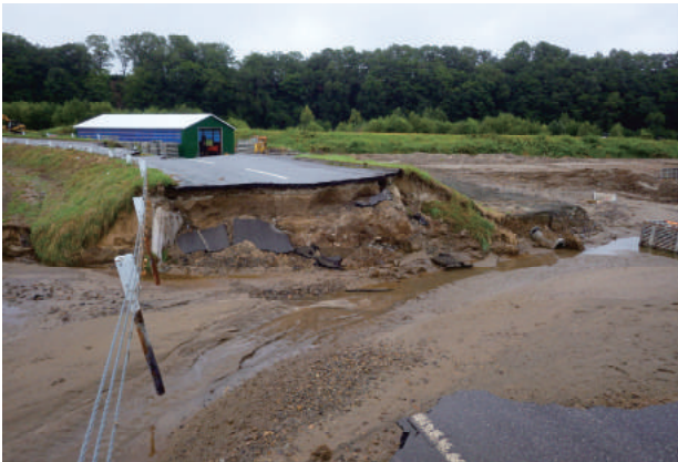
写真-1 北見市の河川氾濫による道路損壊状況（河川氾濫により、写真の左側から右側へ水が流れた）
