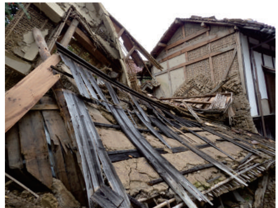
写真-5 北栄町の地震動による家屋倒壊の状況
