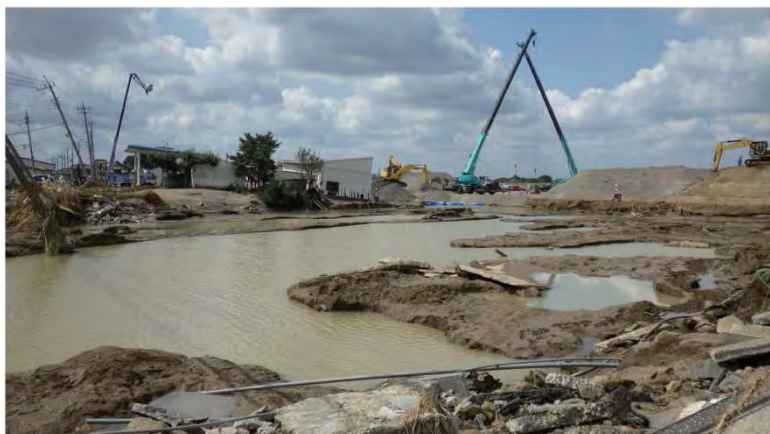
平成27年(2015年)年9月の関東・東北豪雨災害による常総市の堤防決壊現場(奥のクレーン車があるあたりが決壊箇所)
