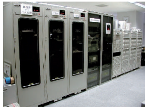
写真-5 宇宙測地館 2 階に設置された相関処理装置。
